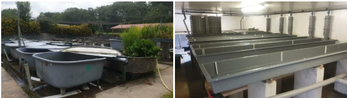
Installations existantes de la pisciculture du Lycée Saint-Christophe
