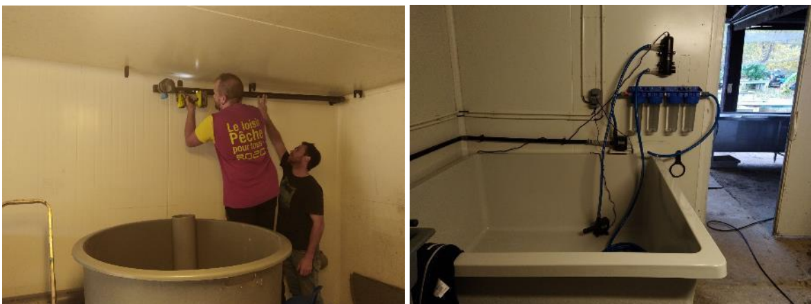
Différentes vues des installations : circuit poissons (à gauche) et bac tampon et filtres à cartouches (à droite)
