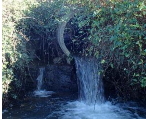
Exemple de buses mal positionnées sur l'Aparaineko, bassin des Aldudes
